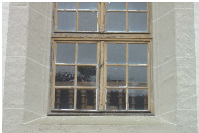
Kirchenfenster Südseite: undicht und morsch
