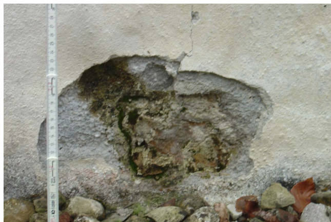
Mauer Nordseite: Witterungsschäden
