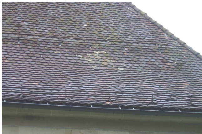
Dach Nordseite: Dachlattenschäden
