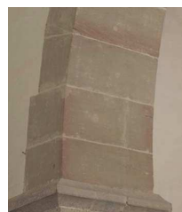
Vom Brand gerötete Sandsteine.
